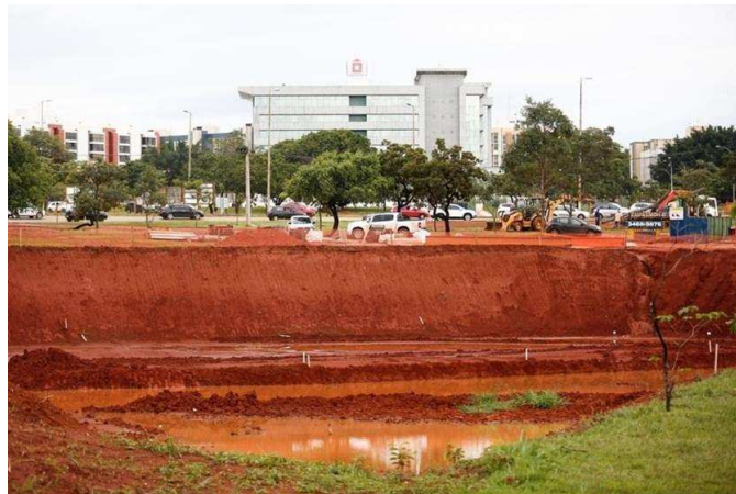
Figura 2- Escavação durante o processo de construção do trevo de triagem norte. Área de impacto ambiental.
