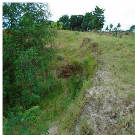
Figura 4: Feição erosiva na cabeceira de drenagem da nascente do Ribeirão Paranavaí.
